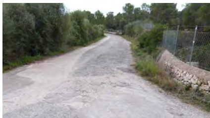
Foto 53. ACTUACIÓ 23. Camí des Presos (Manacor). S'hi aprecia el mal estat del ferm.
