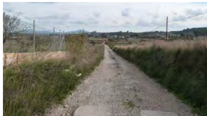
Foto 59. ACTUACIÓ 28. El camí des Rafal Nou, entre Llubi i Maria, presenta un ferm molt degradat.
