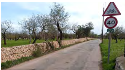
Foto 66. ACTUACIÓ 34. Camí Vell d'Inca a Lloseta. Se'n pot apreciar el ferm en mal estat.
