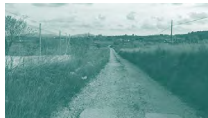
Foto 59. ACTUACIÓN 28. El Camí des Rafal Nou entre Llubí y Maria presenta un firme muy degradado.
