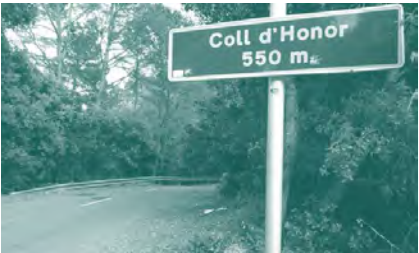
Foto 71. ACTUACIÓN 37. Se necesita mejorar el firme de la carretera Ma-2100, especialmente en el Coll d'Honor.
