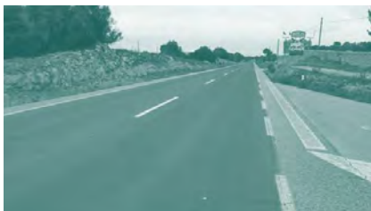
Foto 58. ACTUACIÓN 27. Carretera Ma-12 entre Can Picafort y la Colònia de Sant Pere.
