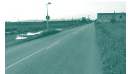
Foto 39. ACTUACIÓN 10. Carretera Ma-5013 entre Sant Jordi y Sa Casa Blanca. Se aprecia la ausencia de arcenes.
