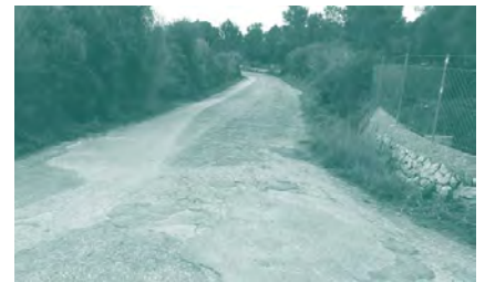
Foto 53. ACTUACIÓN 23. Camí des Presos (Manacor). Se aprecia el mal estado del firme.
