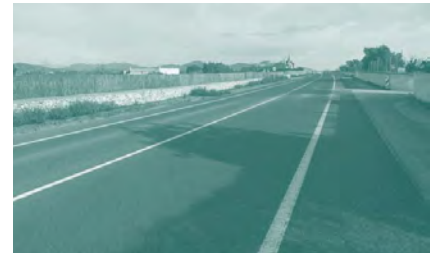
Foto 54. ACTUACIÓN 24. Carretera Ma-4023 entre S'Illot y Son Servera.
