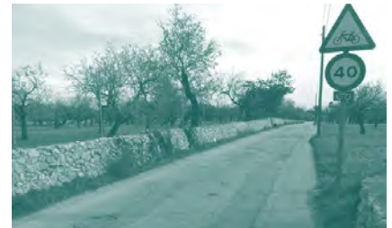
Foto 66. ACTUACIÓN 34. Camí Vell de Inca a Lloseta. Se puede apreciar el mal estado del firme.
