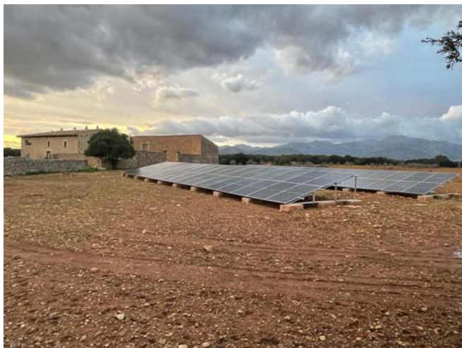
Exemple d'instal·lació fotovoltaica d'autoconsum a Mallorca
