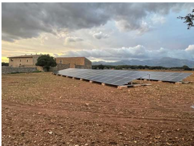
Exemple d'instal·lació fotovoltaica d'autoconsum a Mallorca
