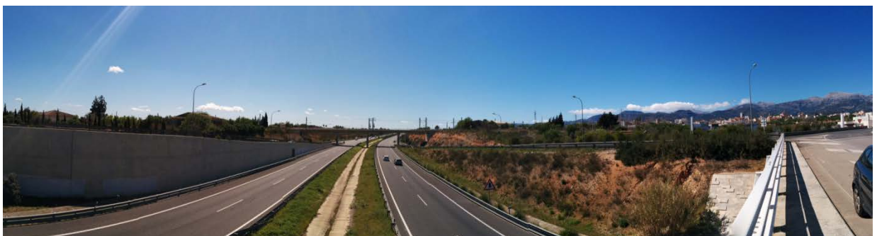
Imatge 13. Talussos no vegetats i amb poc manteniment
